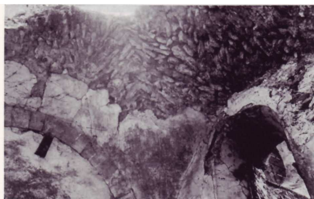
FIG. 5. — SAINT-JULIEN DE MAROLLES-EN-BRIE, RESTES DE LA VOÛTE DE LA TRAVÉE DROITE DE LA CHAPPELLE LATÉRALE NORD
